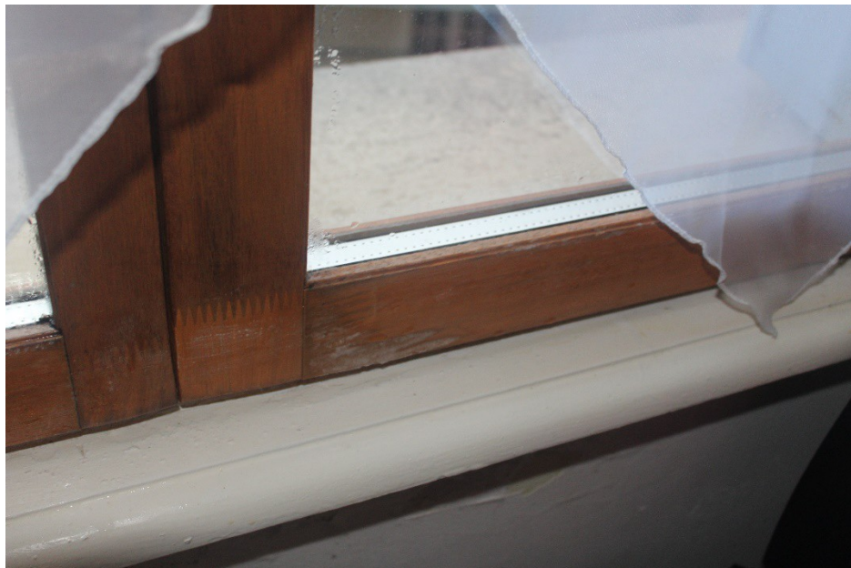
Photo n°7 : bas fenêtre salon : condensation sur vitrage et début de mycoses
