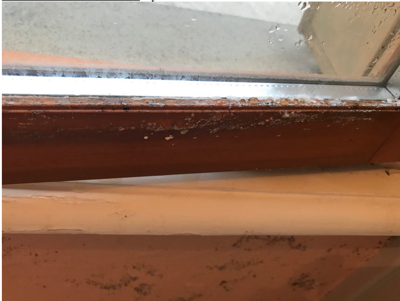
Photo n°19 : Salle de douche : mycoses sur fenêtre et condensation
