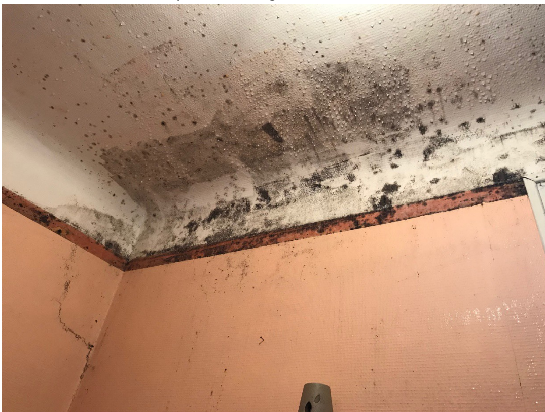
Photo n°14 : Salle de douche: mycoses en angle de mur et condensation
