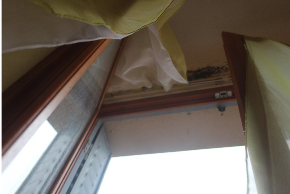
Photo n°6 : Fenêtre Salon : mycoses au dessus fenêtre
