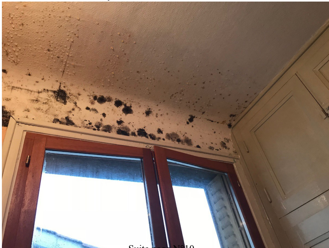
Photo n°15 : Salle de douche: mycoses au dessus fenêtre et condensation
