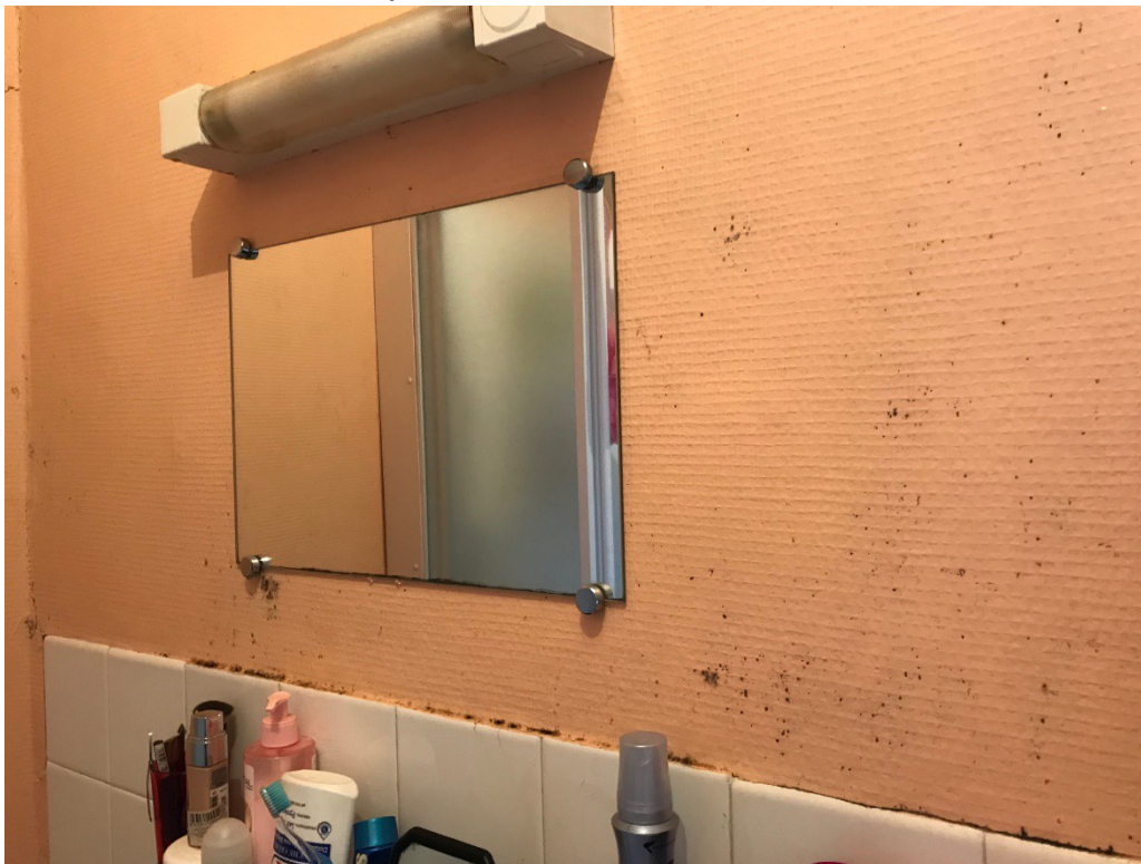
Photo n°17 : Salle de douche: mycoses sur toile de verre en sous bassement de fenêtre et condensation
